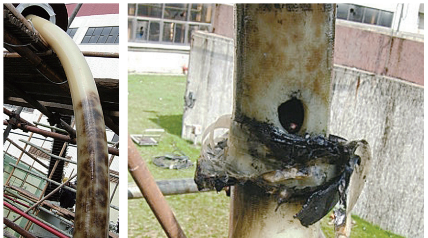
Рис. 2. Слева: водный дендрит, появившийся из-за взаимодействия электрического поля и влаги. Справа: крупный план поврежденного слоя изоляции.
